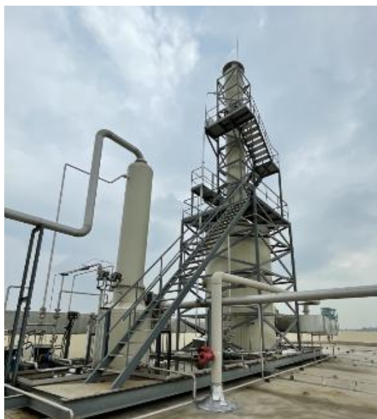
513 废气处理设施
