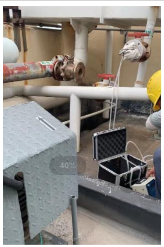
废气采样口 M
