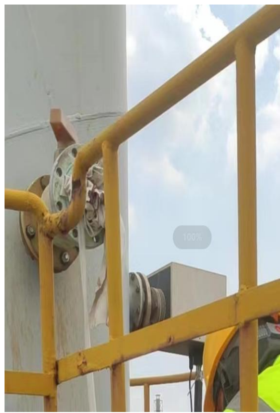
废气采样口 H
